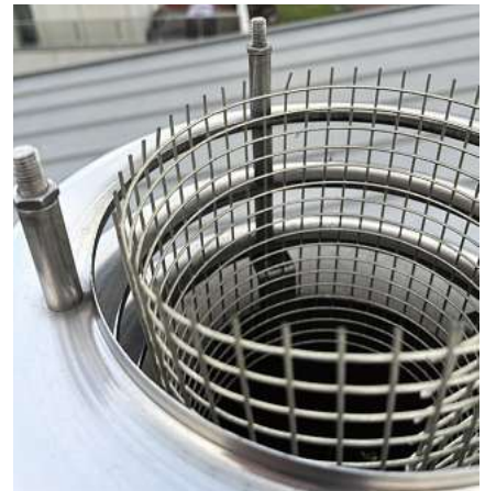
🐦 Protezione per gli uccelli a maglia grossa allo sbocco del camino
