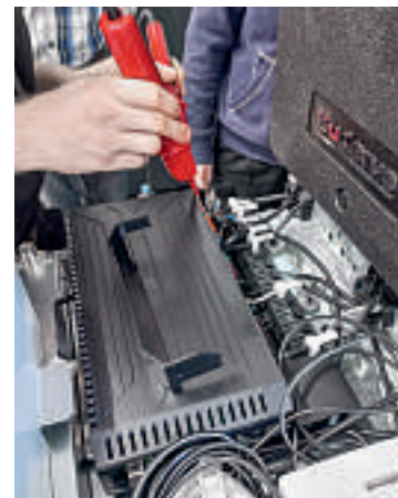
Mesurer et contrôler le voltage et la polarité des tensions d'entrée sur des générateurs de chaleur.
