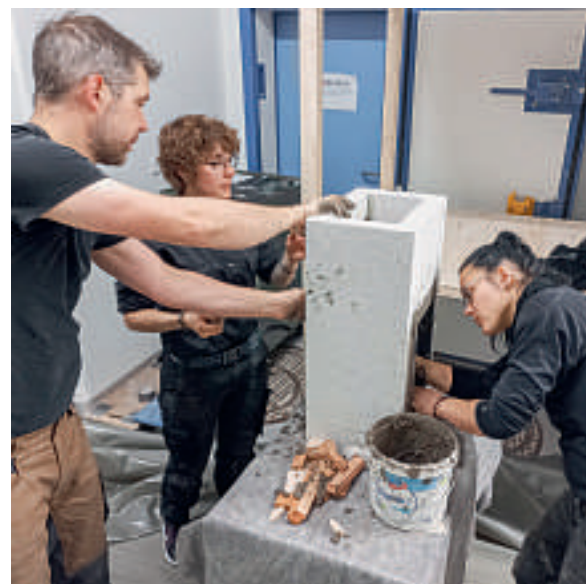
Pratica nella costruzione di stufe sotto la guida di un esperto del settore.
