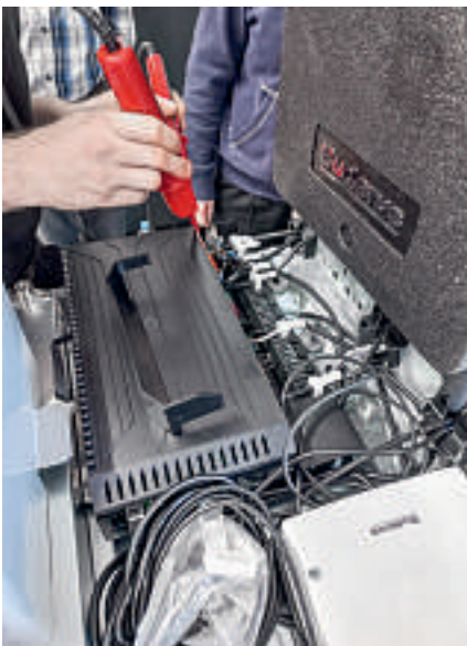
An Wärmeerzeuger Eingangsspannungen Volt und Polung messen und kontrollieren.
