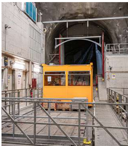
La funicolare più robusta all'interno della centrale elettrica.
