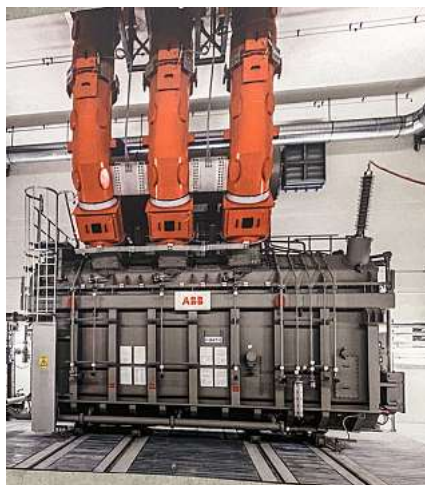
L'elettricità appena generata viene trasportata in tubi metallici rossi con un conduttore al centro.
