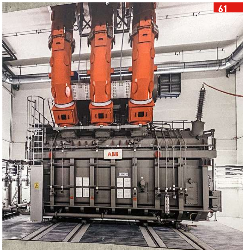
L'électricité tout juste produite est transportée dans des tubes métalliques rouges avec un conducteur au milieu.
